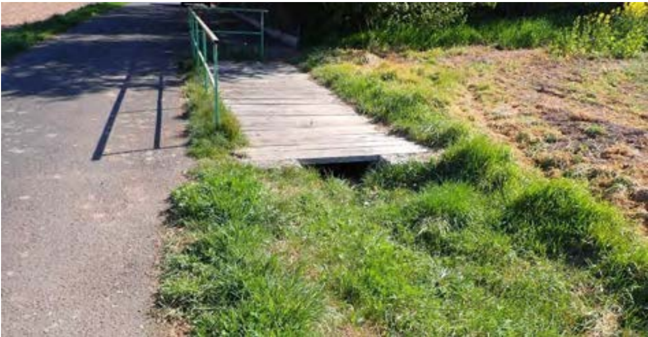
Abb. 71: Sandfang am Wirtschaftsweg in Verlängerung der Herlenbergstraße
