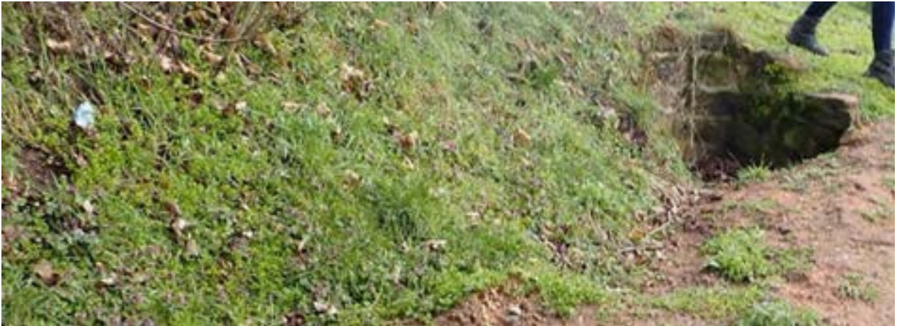
Abb. 97: Nicht angeströmtes Zulaufbauwerk zum Regenwasserkanal
