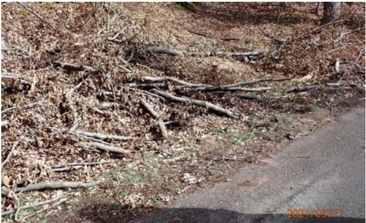
Abb. 59: Wegseitengraben mit Abflusshindernissen
