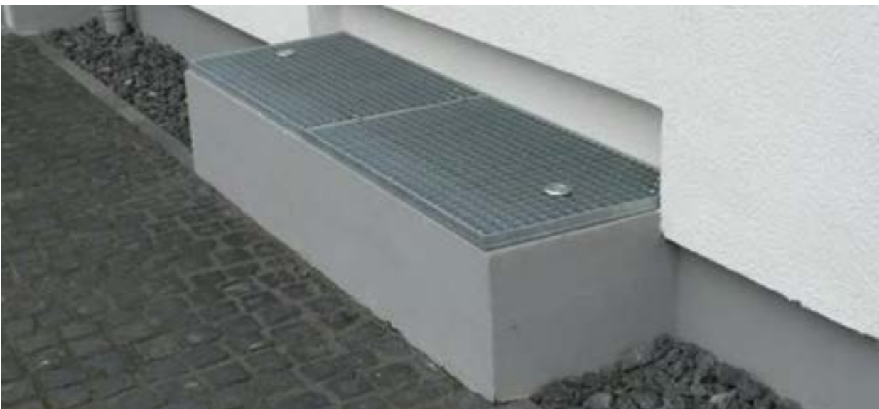
Abb. 17: Beispiel für die Sicherung eines niveaugleichen Lichtschachtes Örtliches Hochwasser- und Starkregenvorsorgekonzept OG Enkenbach-Alsenborn
