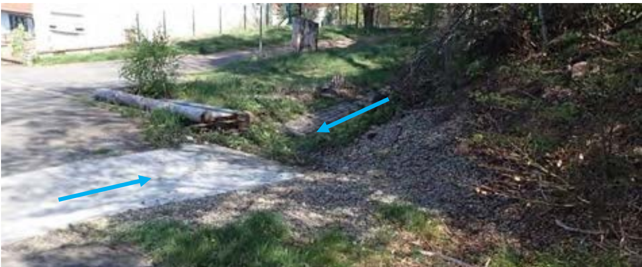
Abb. 63: Querrinne und Sandfang am oberen Ende der Leiningener Straße
