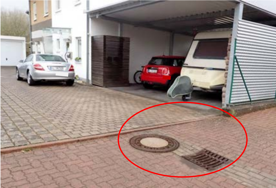
Abb. 33: Überstaugefährdeter Straßenablauf und Kanalschacht im Geländetiefpunkt
