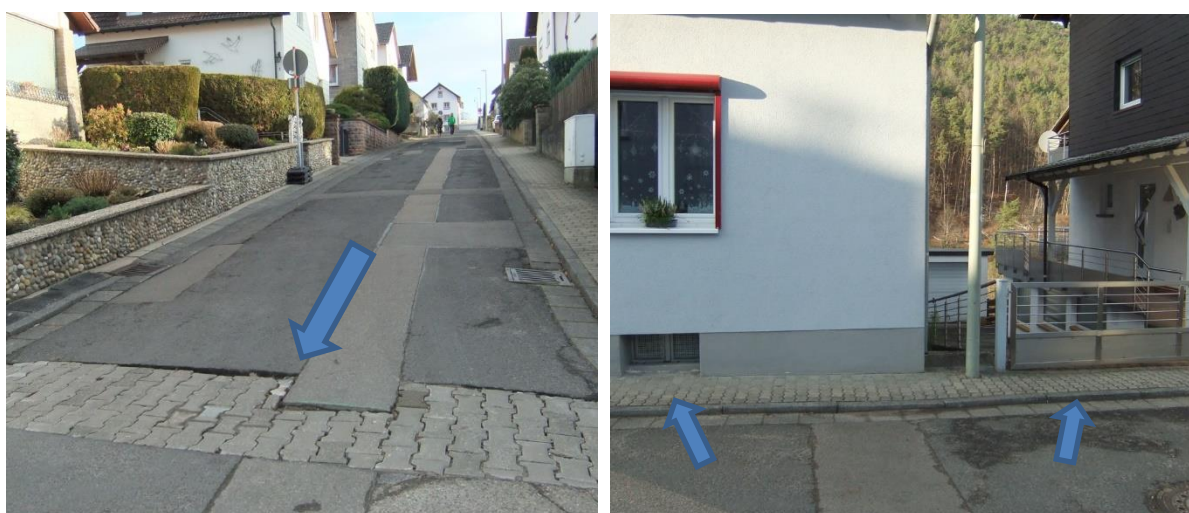
Abbildung 11: Zufluss aus Straße mit starkem Gefälle (links), Gebäude mit tief liegenden Öffnungen, bzw. tiefliegende Garage im Anströmbereich (rechts)
