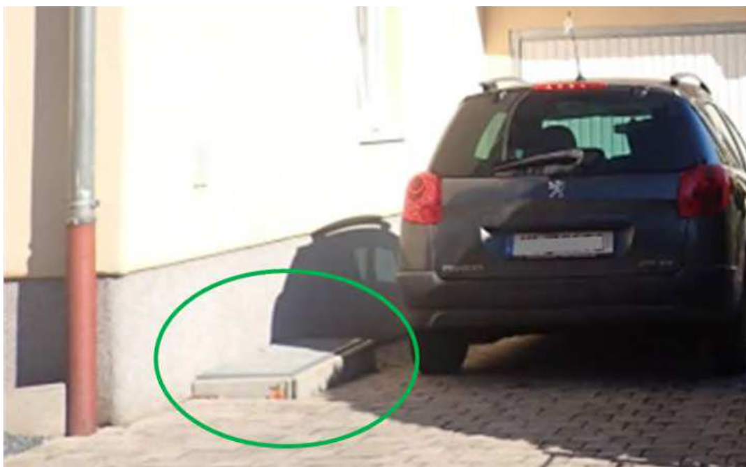
Abb. 17: Beispiele für die Sicherung eines niveaugleichen Lichtschachtes
