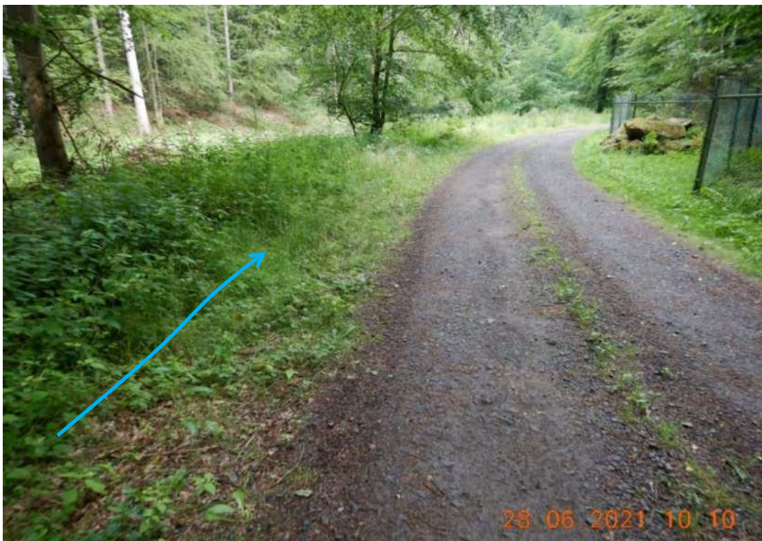
Abb. 55: Wiederherzustellender Wegseitengraben zur natürlichen Senke
