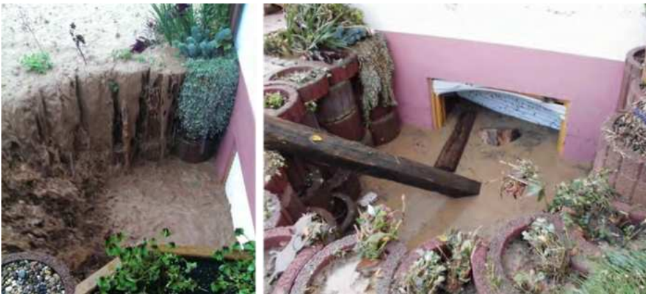
Abb. 14: Überflutete Souterrainwohnung im Moscheltal 2014
