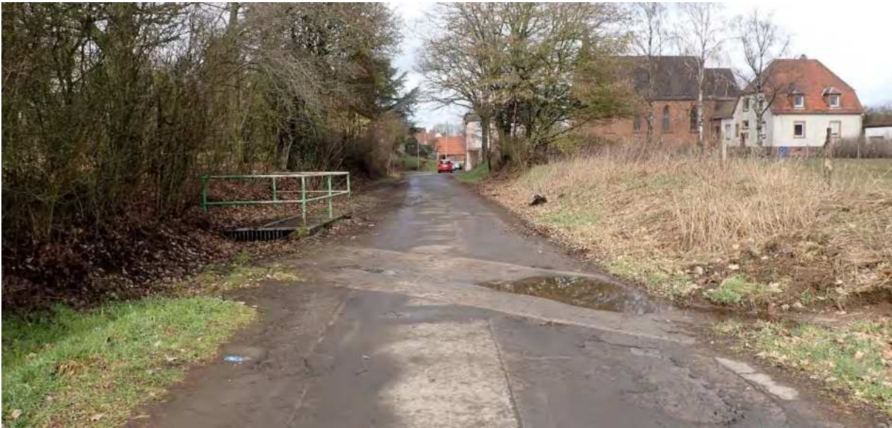
Abb. 40: Querrinne und Sandfang in der Fischbacher Straße
