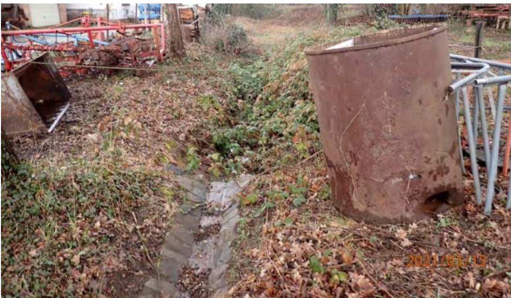
Abb. 79: Rinne zur Ableitung von Oberflächenwasser der Straße
