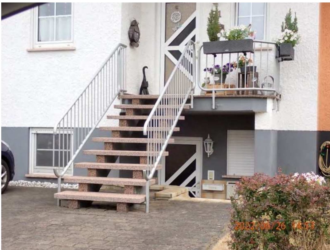
Abb. 12: Überflutungsgefährdete Keller durch außenliegende Tür
