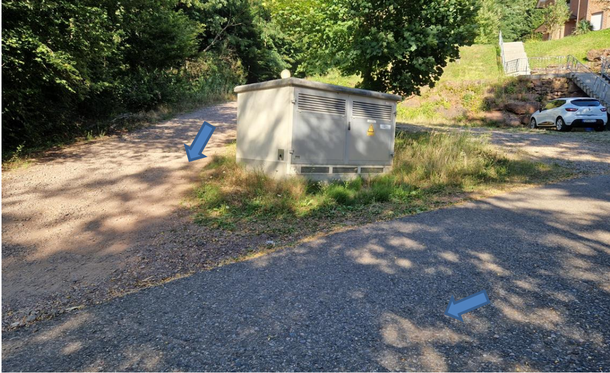
Abbildung 162: Blick auf Stromverteilerkasten im Notabflussweg Aspenkehle
