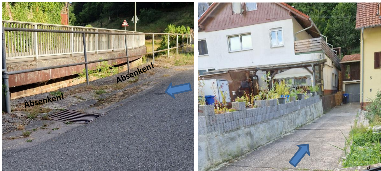
Abbildung 98: Mauerkrone der gewässerbegrenzenden Mauer, tiefliegende Zufahrt mit Garage (rechts)
