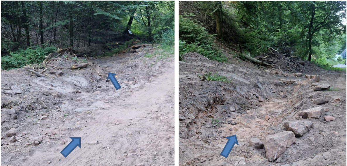
Abbildung 150: Querschlag mit wegbegleitender Mulde oberhalb Hintertalstraße (links), freigelegtes Einlaufbauwerk mit vorgeschalteter Mulde oberhalb Hintertalstraße (rechts)
