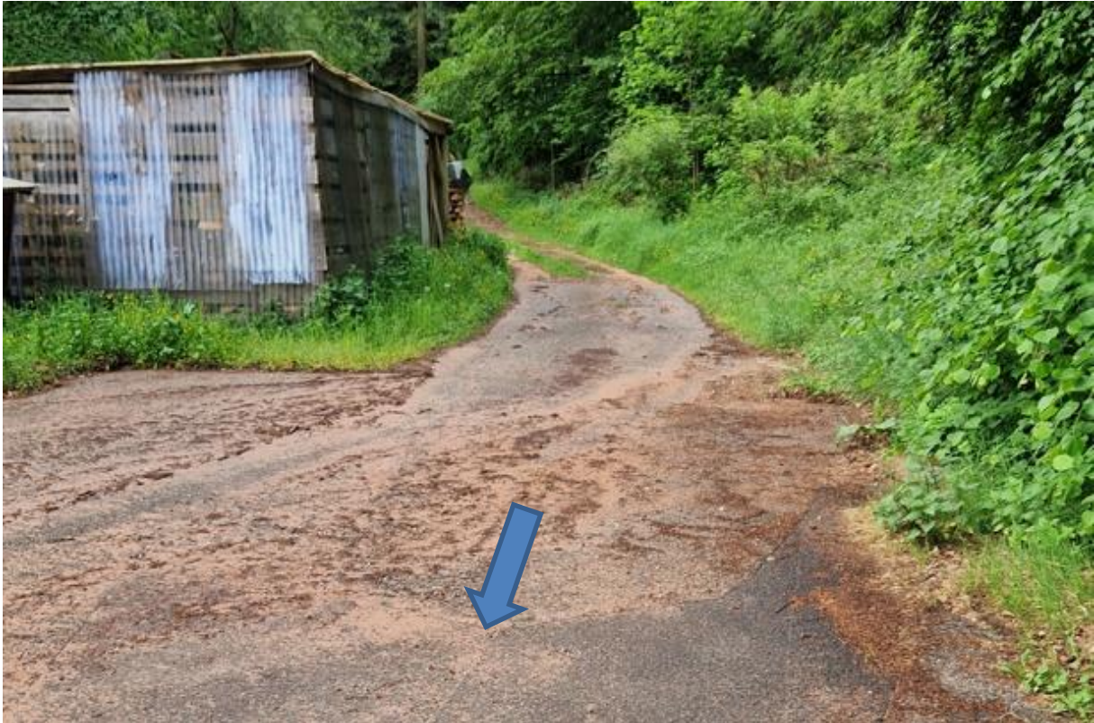
Abbildung 102: Südwestliches Ausbauende der Ortsstraße mit Sandeintrag aus Außengebiet
