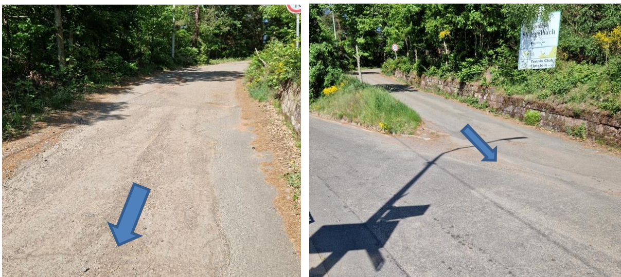
Abbildung 128: Weg zum Sportplatz mit Erosionsspuren (links), Einmündungsbereich zur Eschkopfstraße (rechts)
