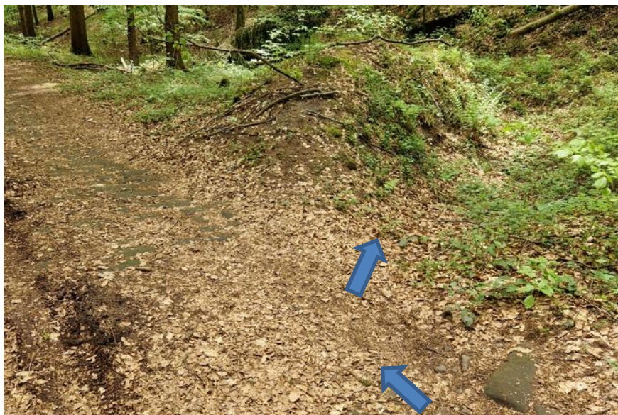
Abbildung 154: Querschlag mit wegbegleitender Mulde oberhalb Vordertalstraße vor Instandsetzung
