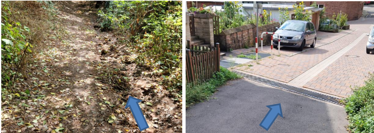
Abbildung 264: Waldweg oberhalb "Am Kreuzberg" mit Erosionsspuren (links), Sandfang "Am Kreuzberg" (rechts)
