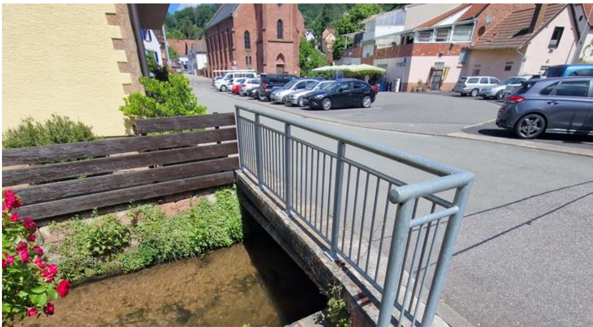
Abbildung 276: Auslauf der Verrohrung des Hochspeyerbachs im Bereich des Dorfplatzes
