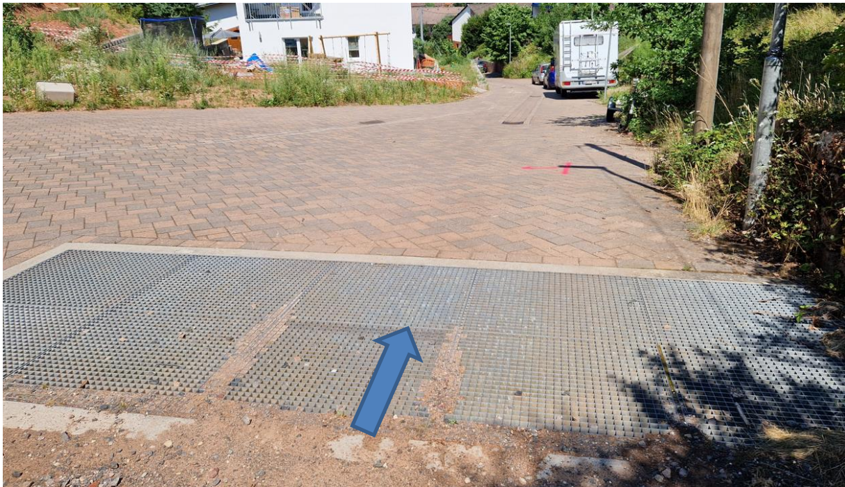
Abbildung 246: Sandfang am Ausbauende der Lambertusstraße
