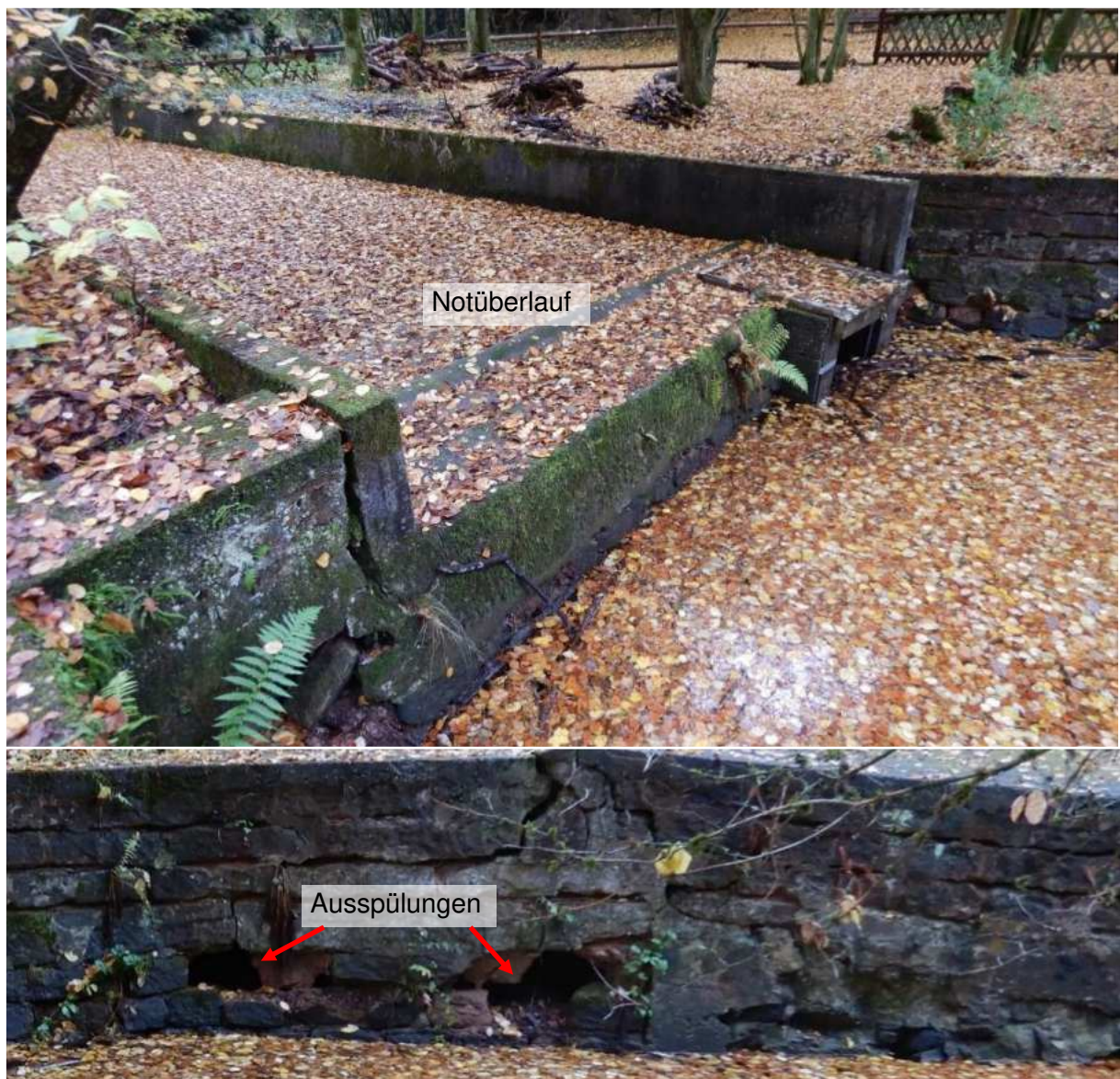
Abbildung 15 Situation Woog am Glasbach, ausgespülte Mauer
